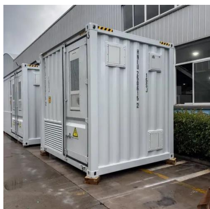
2MW Lithium ion BESS Container
